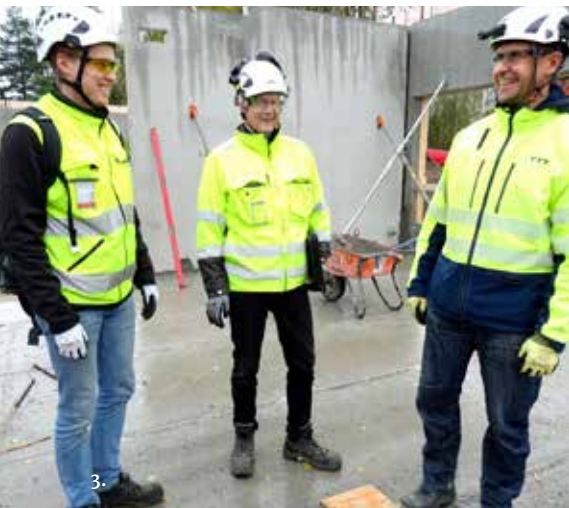
Kuva 3: Hyvinkään kaupungin Sami Husu (vas.) ja Jyrki Kauppinen sekä YIT:n Ari-Pekka Laitinen tarkastivat runkovaiheen etenemistä.
