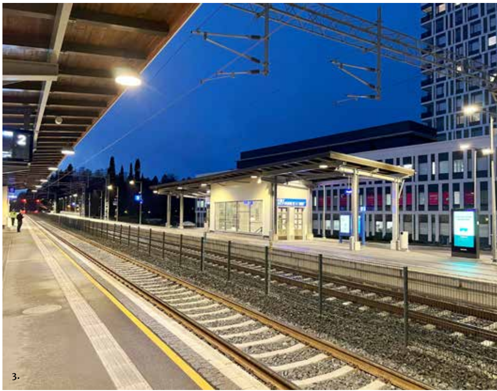
Kuvat 3, 4 ja 7: Kuopion aseman laiturikatokset on peruskorjattu 1930-luvun tunnelma säilyttäen. Osana aseman toiminnan parantamista tehty myös uutta katosrakennetta laiturille 3.
